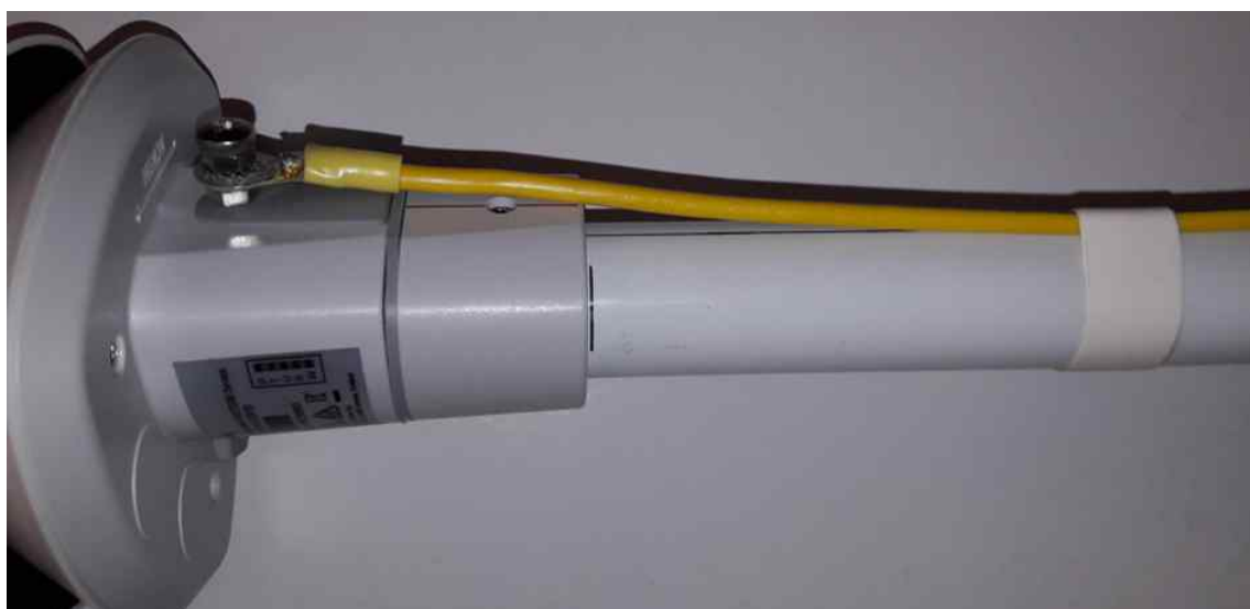
Photo 20 : Détail de la mise à la terre de la station WXT 536
